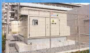
自家発電設備
