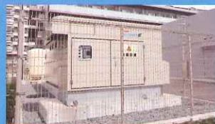
自家発電設備
